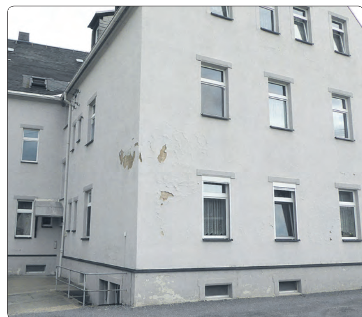
Nicht nur die marode Fassade des Gebäudes war von den Jahren gezeichnet.
